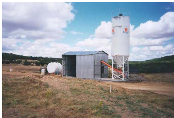
Figura 24. Central de fabrico de caldas de injeção
